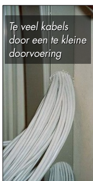
De kabels liggen onbeschermd op de scherpe rand, de kans op beschadiging is groot
