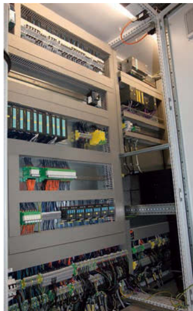
Bord H6: Algemeen sturingsbord (Safety PLC, UPS, 24VDC-verdeling ...)
