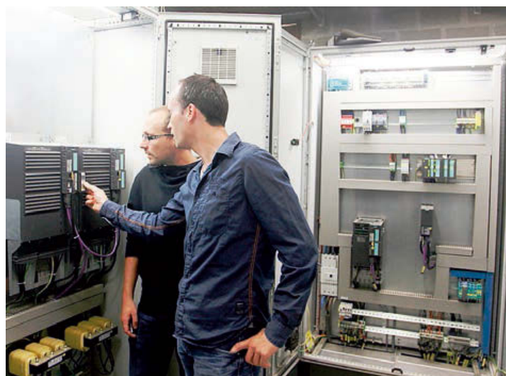
Dirk Van Gestel (links) en Guy Beyens ontwierpen en installeerden de procesinstrumentatie met elektriciteitswerken voor de biogasinstallatie
