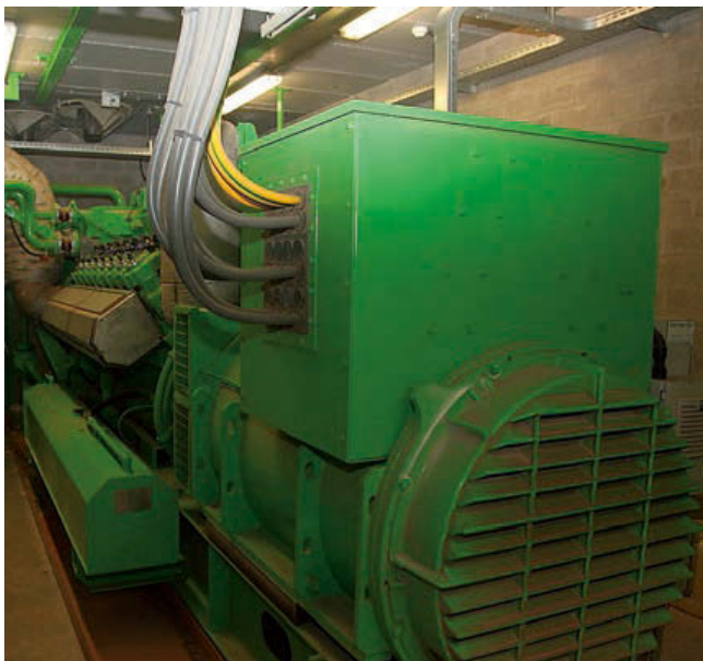
De biogasinstallatie heeft twee warmtekrachtkoppelingen met een vermogen van 1,2 MW. Voor elk onderdeel van de installatie is een back-up aanwezig
