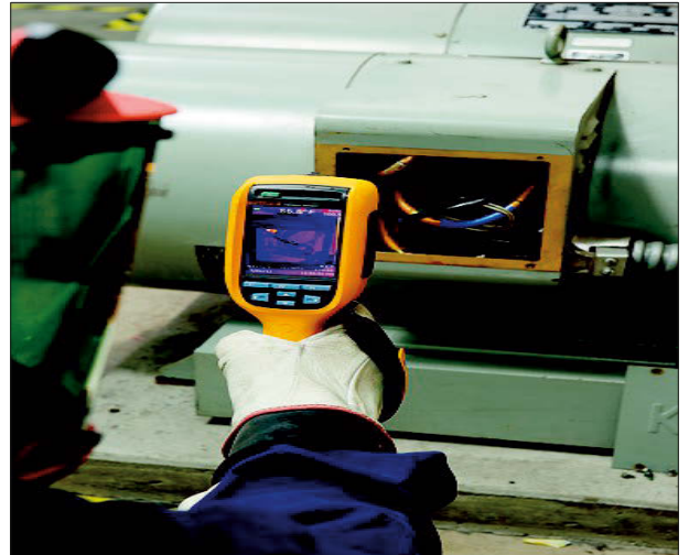
Bij elektrische installaties staat warmte doorgaans gelijk aan verlies. Daarom kunnen warmtebeeldcamera's heel nuttig zijn in het identificeren van slechte contacten en stroominefficiënties
