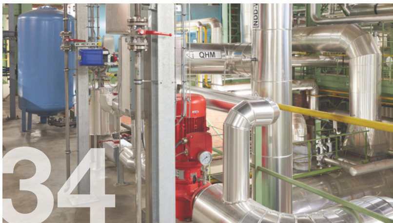
EDF Luminus Elektriciteitscentrale Ham
