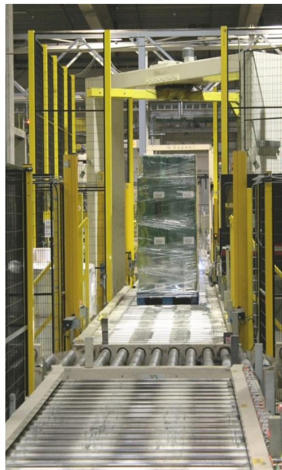
Bij onderhoudswerken moest de centrale verpakingslijn telkens volledig stilgelegd worden. Dankzij het nieuwe veiligheidsconcept waarbij de lijn in stukken opgedeeld werd, is dit niet langer het geval
