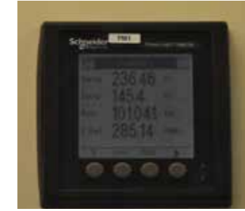
Power meter op de hoofdschakelaar
